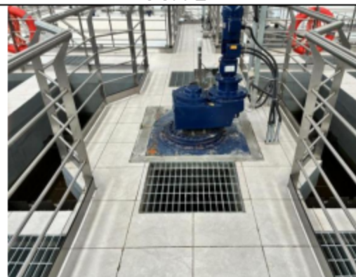
浓水系统沉淀池
