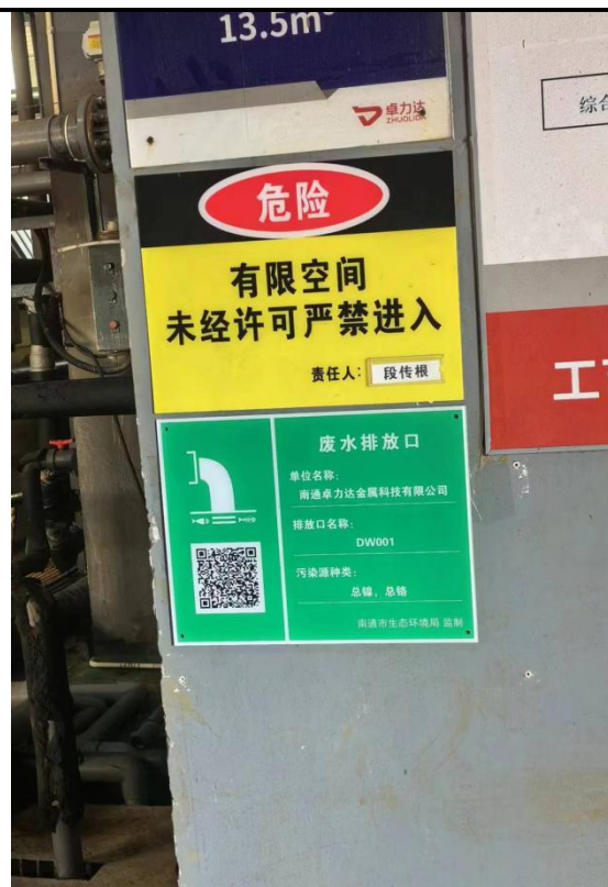
铬、镍废水车间排放口、标志牌 (DW001)
