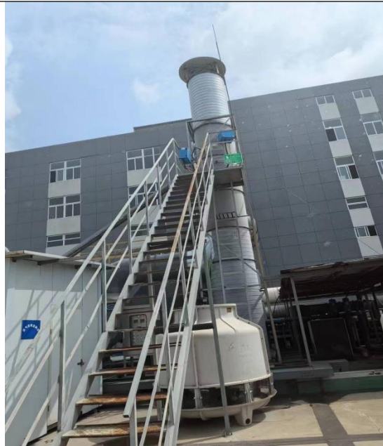
废气排气筒、采样平台、采样口
