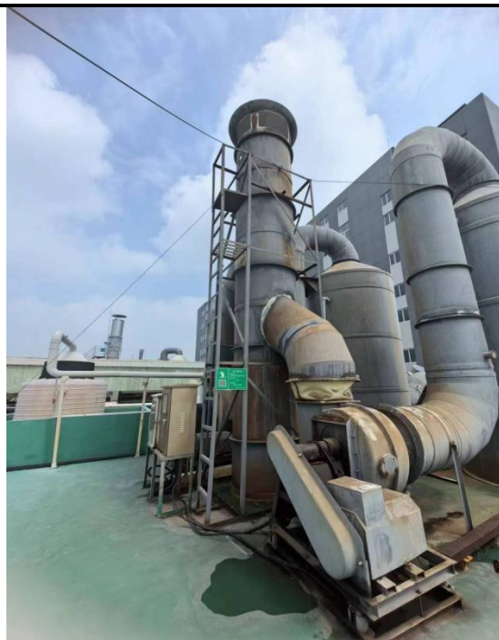
废气排气筒、采样平台、采样口、喷淋塔
