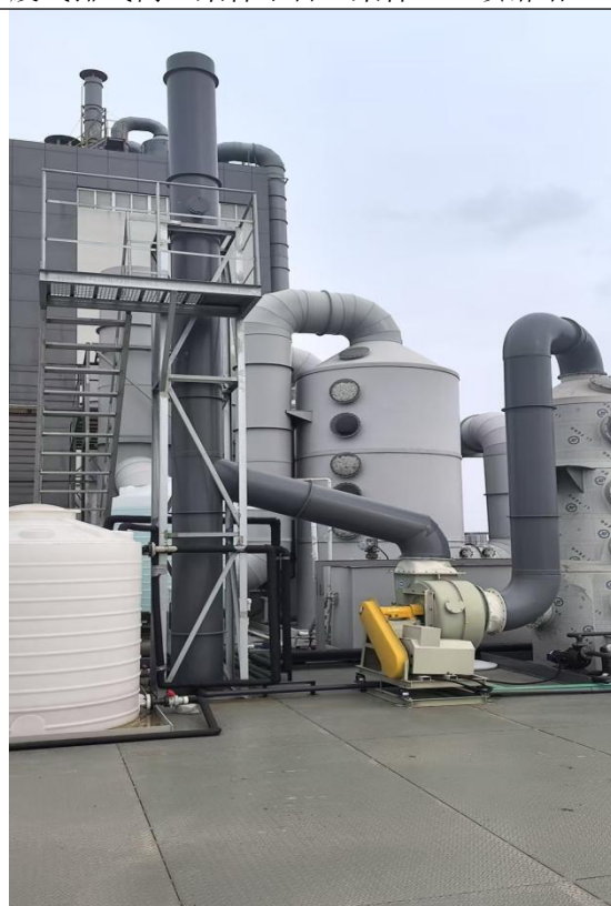
废气排气筒、采样平台、采样口、喷淋塔
