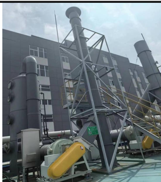
废气排气筒、采样平台、采样口、喷淋塔
