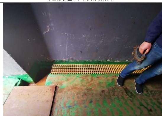
危险固废仓库（导流沟、防渗措施）
