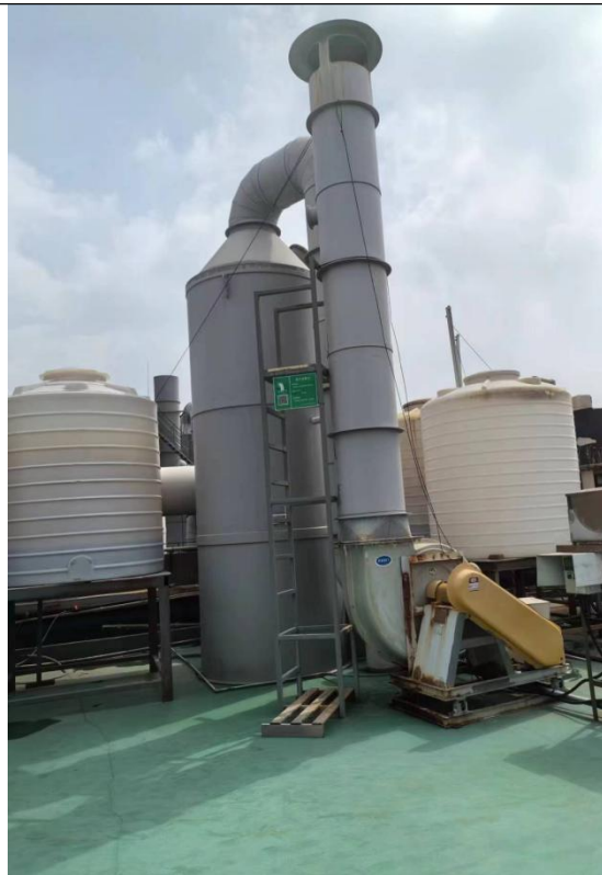
废气排气筒、采样平台、采样口、喷淋塔
