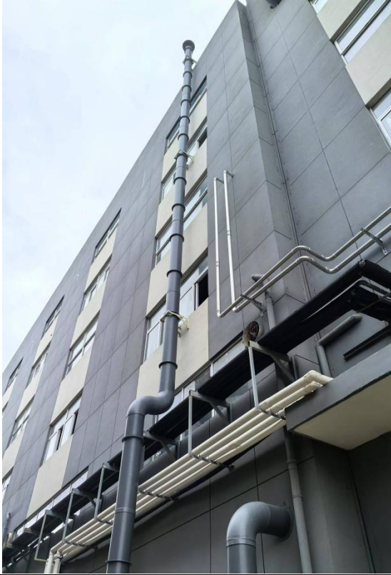
废气排气筒、采样口
