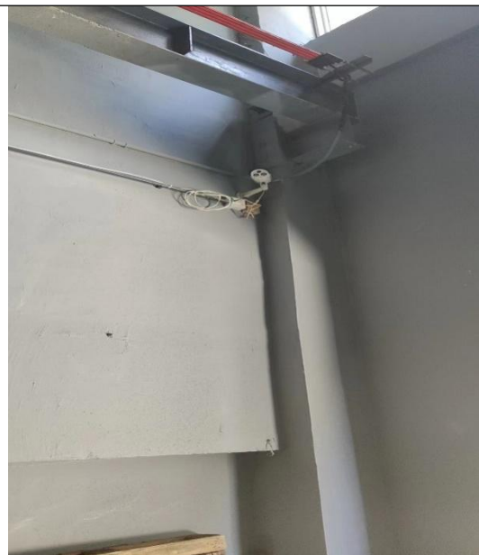
危废仓库摄像头（正对危废内部门）
